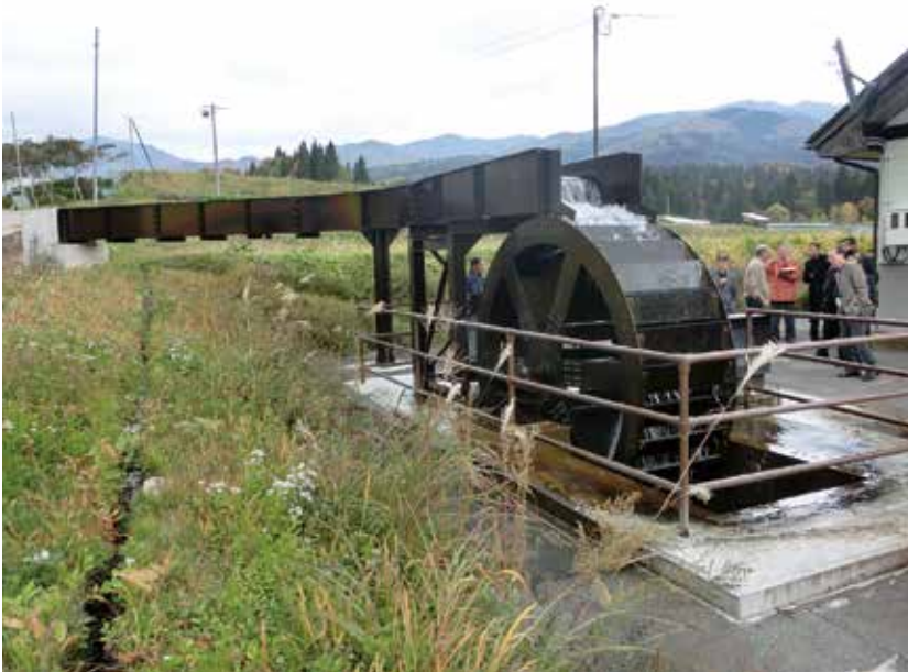
石徹白の小水力発電用水車（写真提供：NPO法人地域再生機構）
