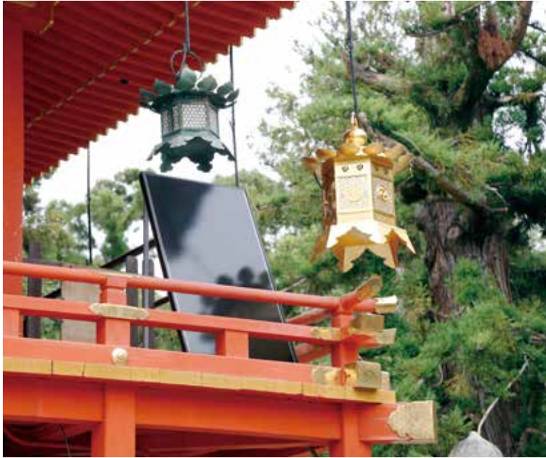
本殿の灯籠の脇に設置された太陽光パネル
